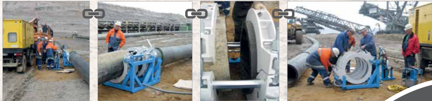
• Vorbereitungen zum Verbinden zweier Rohrstränge DA 630 auf dem Tagebau-Gelände und fertige Schweißnaht
