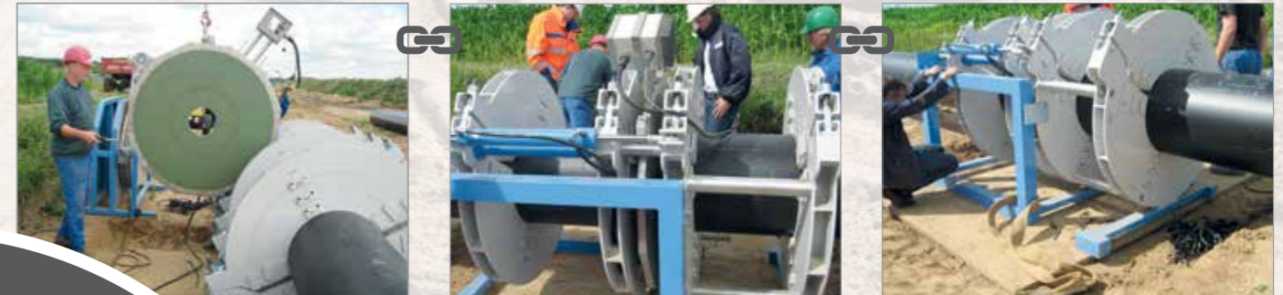
• Einsetzen des Heizelements zum Anwärmen der beiden Rohrenden DA 560 und Kontrolle der Schweißnaht
